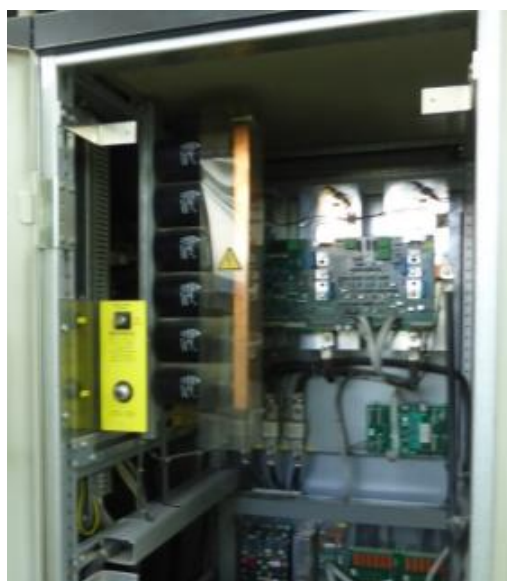
Elektronik der alten Anlage
