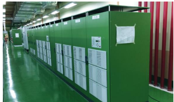
Einheitlich aussehende Installation von USV-Anlagen
