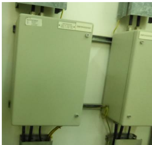
Batteriesicherungskästen (wurden behalten)
