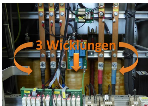
Transformator (wurde behalten)
