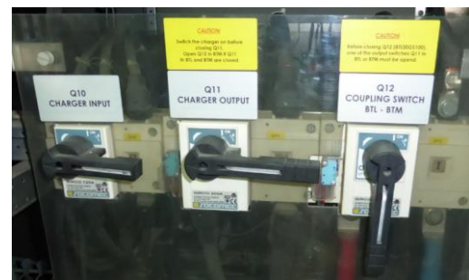
Schalter (wurden behalten)
